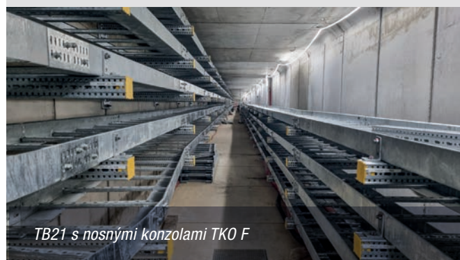
Držáky siFramo v budově tokamak
